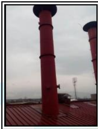
Слика бр. 3: Испуст на мерно место – Котел 1
