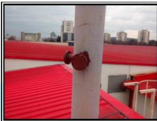
Слика бр. 3: Испуст на мерно место - Котел 3
