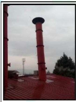
Слика бр. 5: Испуст на мерно место – Котел 2
