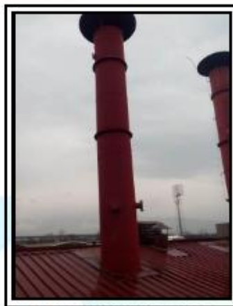
Слика бр. 3: Испуст на мерно место - Котел 1
