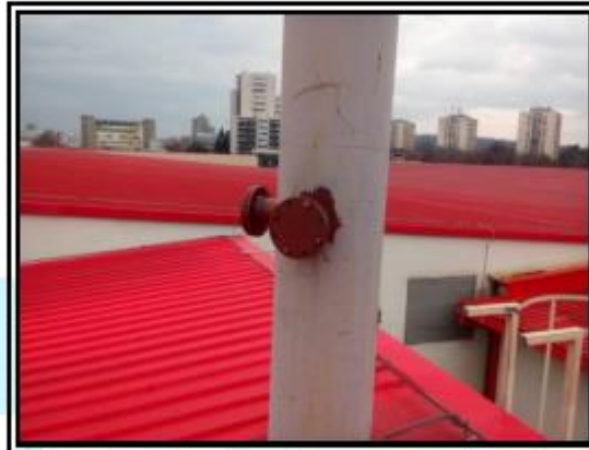
Слика бр. 7: Испуст на мерно место – Котел 3
